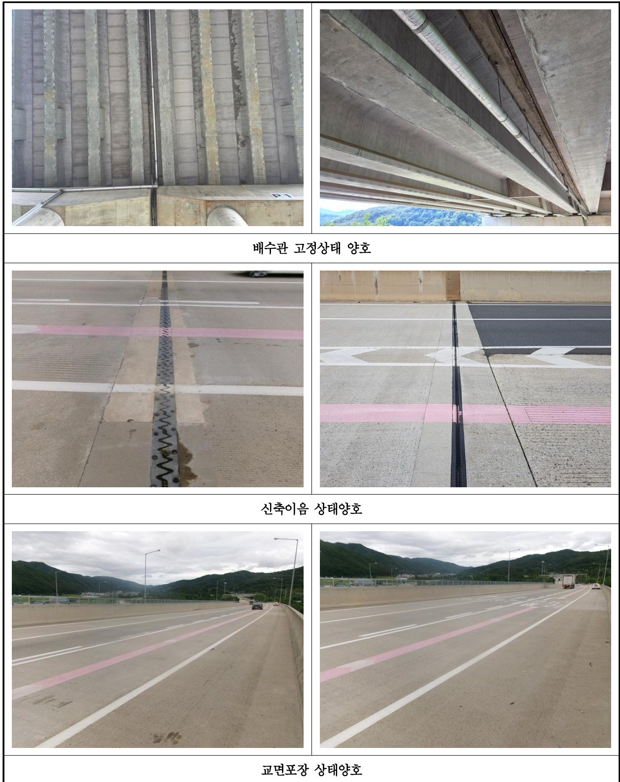
【사진 14.3.51】 교량의 공중이용시설 10대 위험요소 손상현황(계속)
